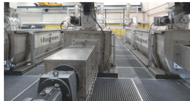
Biogreenユニット
